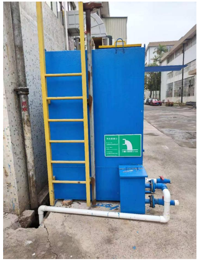
生活污水排放口DW001 (远照)
