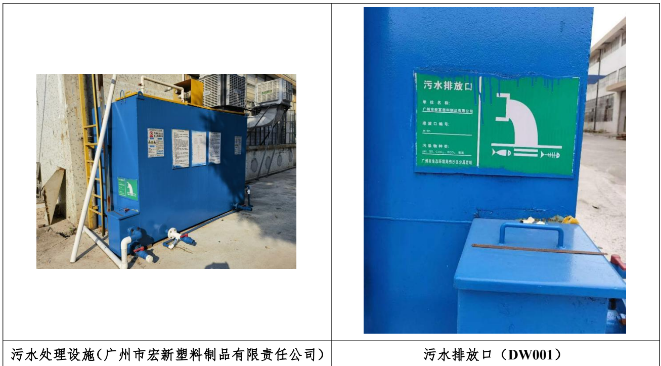
图3-2 废水排放及处理设施情况
