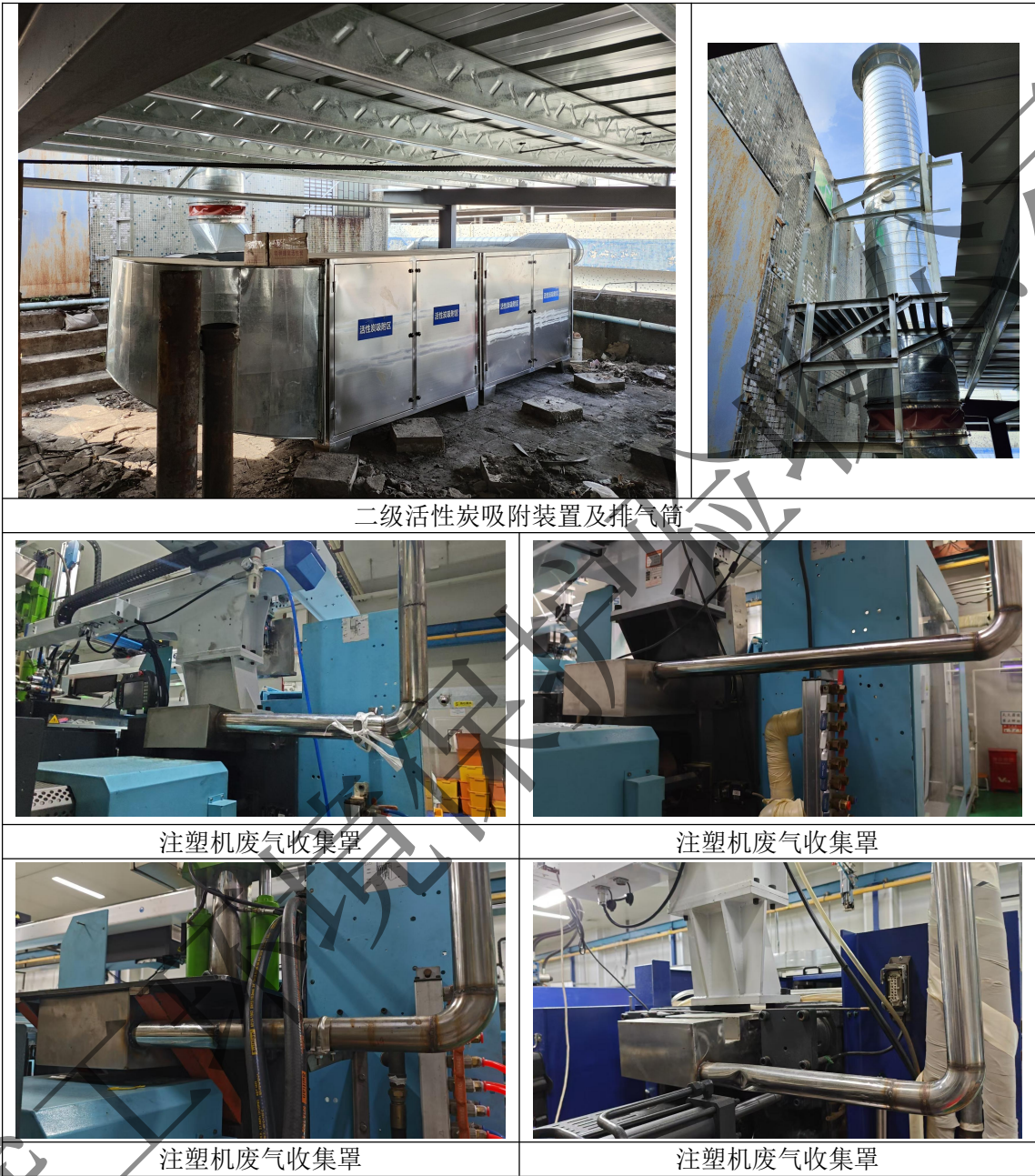
图 4.1-4 废气治理设施现场照片
